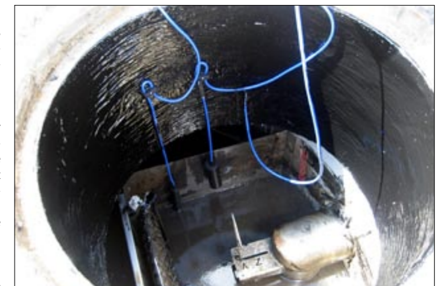
Ein sanierter Schachtaufbau mit Warnanlage.
