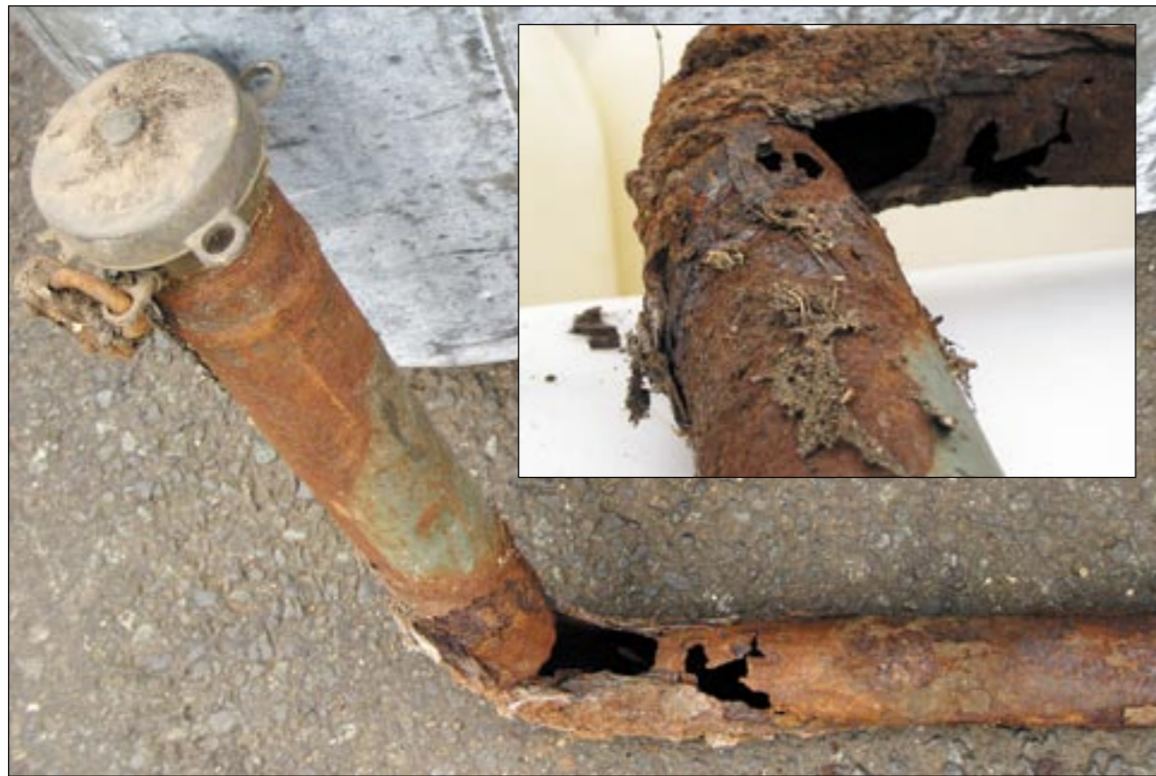
Völlig durchgerostet: Mitarbeiter entdeckten bei Montagearbeiten diese Füllleitung. Öl lief dennoch nicht ins Erdreich.
