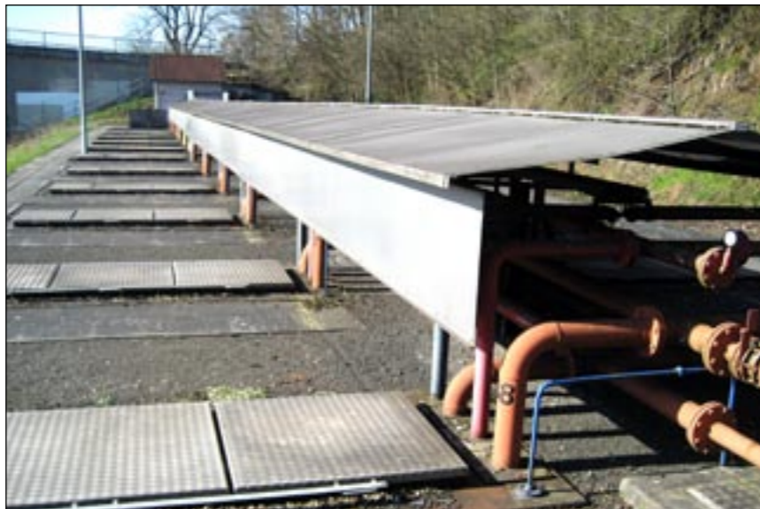
Großauftrag: Verfüllung zur endgültigen Stilllegung von zwölf Tanks zu je 80.000 Liter und vier Tanks á 100.000 Liter im ehemaligen Lomo Tanklager Bad Hersfeld.
